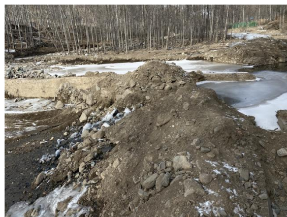
初麻乡人饮管网现状
