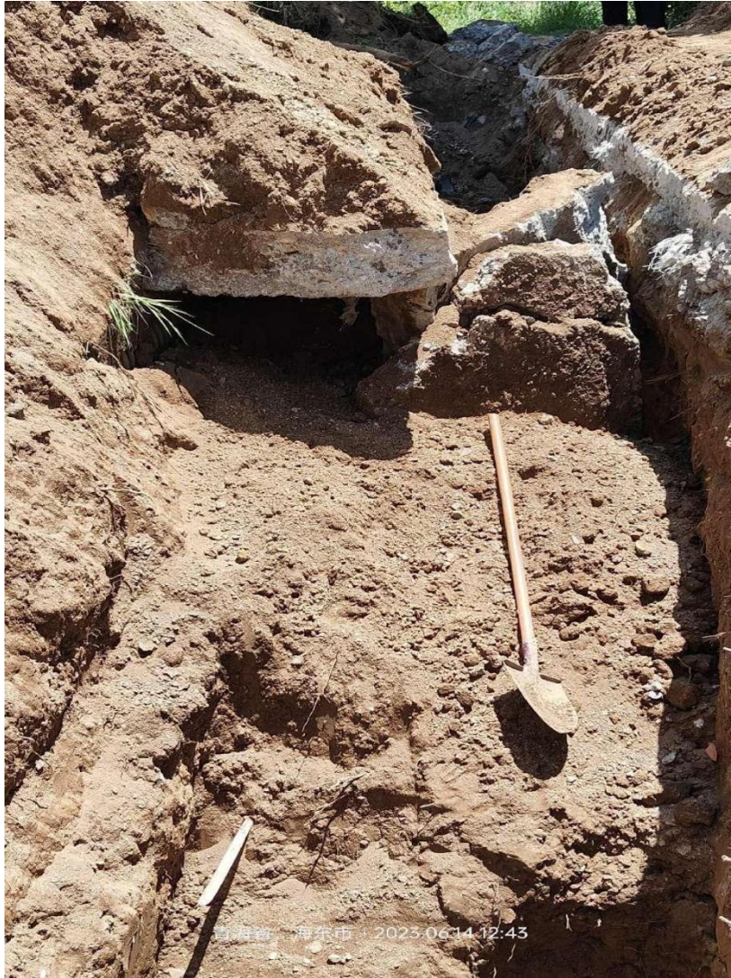
塌坍的坑道内悬空的硬化路水泥块和上方堆积的弃土
